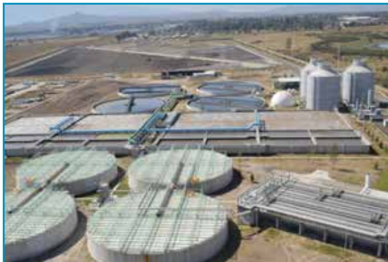
Biogas plant, El Ahogado, Jalisco.
