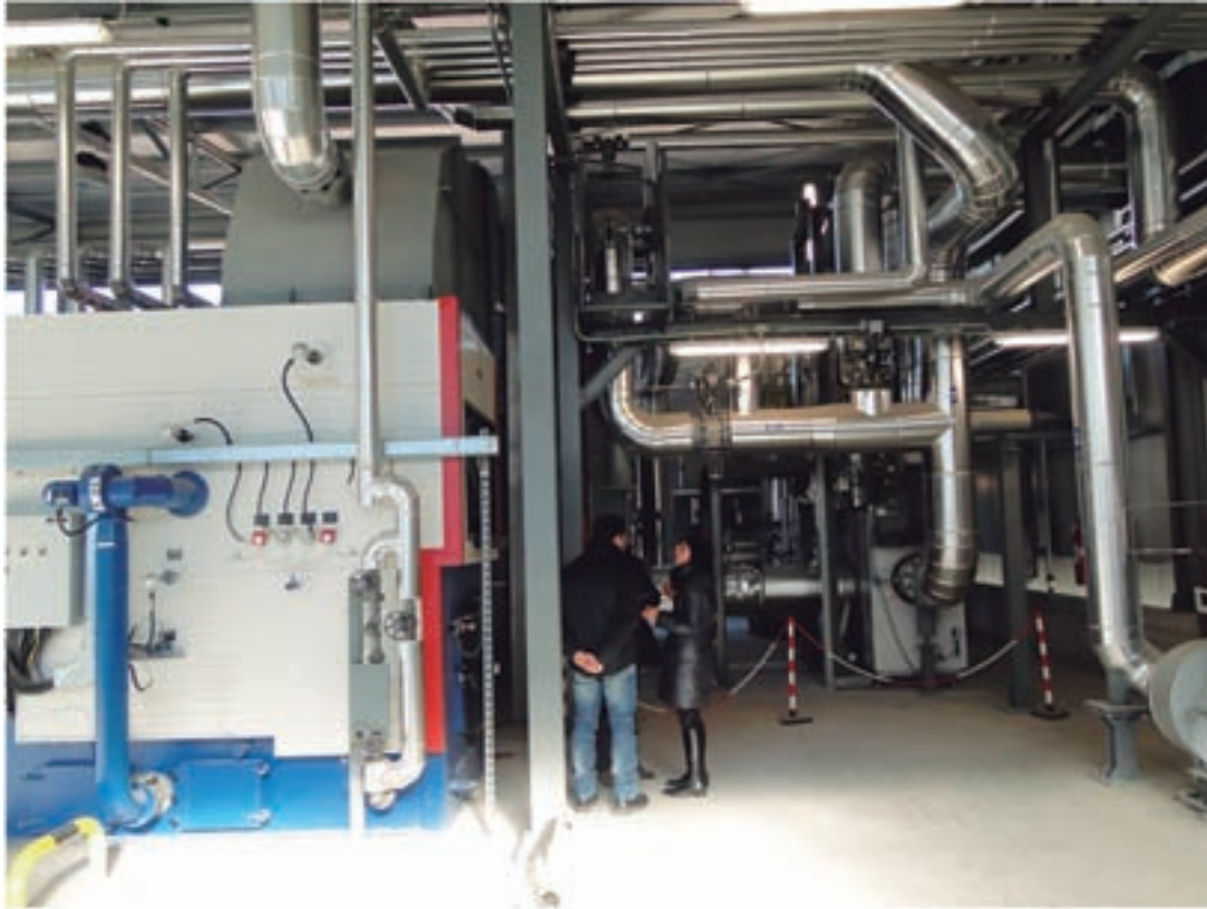
Figura 7.27 Fotografía de una unidad EFGT Turbec 100. A la izquierda se ve el horno de biomasa, en la parte de atrás del intercambiador de calor y a la derecha la turbina de gas
