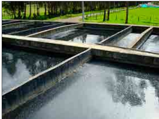
Deficiente tratamiento de aguas residuales
